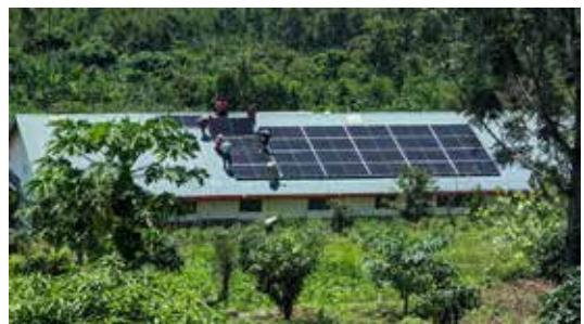
PV-Energie für den Werkstattbetrieb
